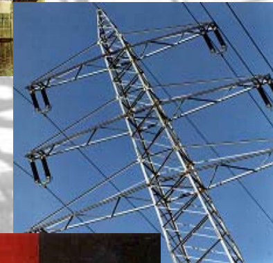
Strommast Quelle: Wiegel
